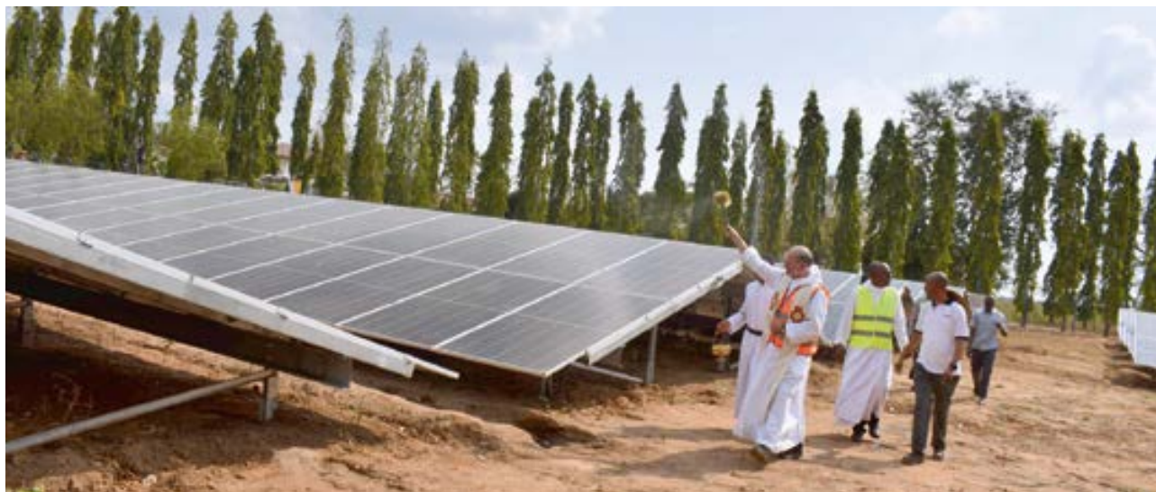
Abt Emmanuel (Uznach, Schweiz) und Abt Romain (Agbang, Togo) weihen mit Abt Christian die neue Solaranlage in Ndanda ein
