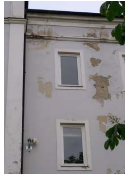
Der Zahn der Zeit: Schäden an den Schulgebäuden werden unübersehbar
