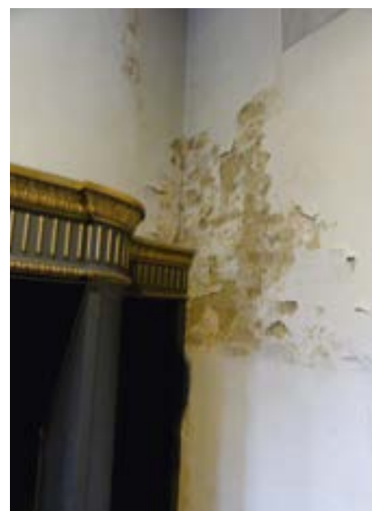
Seitenkapelle: Schäden am Putz und im Mauerwerk
