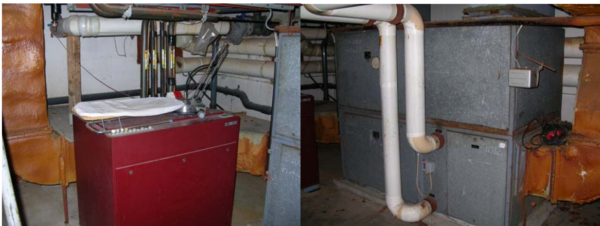
Abbildung 9-1: Defekte Wärmepumpe (links) und Lüftungsgerät (rechts)
